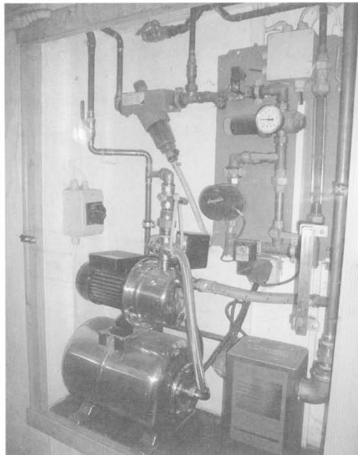
Abb. 5: Einbaubeispiel einer Grander-Wasserbelebung in der Mühle Ingersleben
